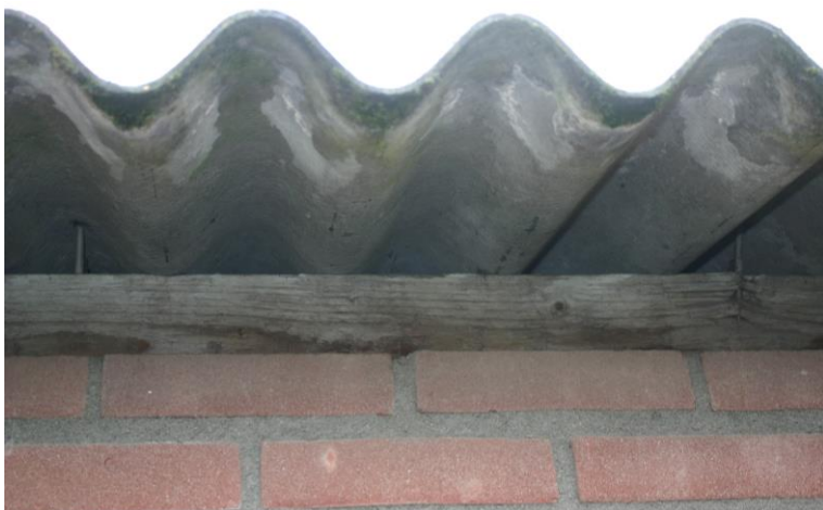
Figuur 4.2.2. Op enkele plekken waar nog isolatieplaten onder het plafond aanwezig zijn, is de ruimte onder de ‘golven’ open. De spouw is afgedicht met een muurplaat.
