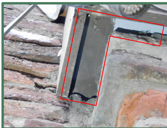
Foto 4: Opening bij houten plank.
