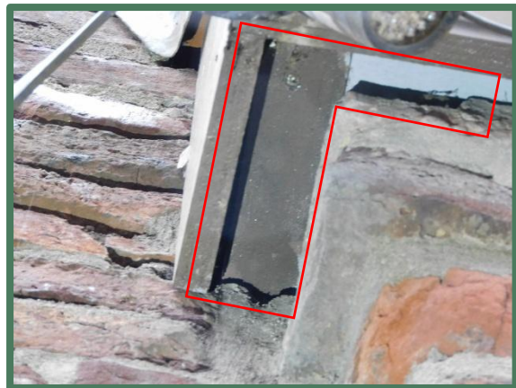
Foto 15: Opening bij houten plank.
