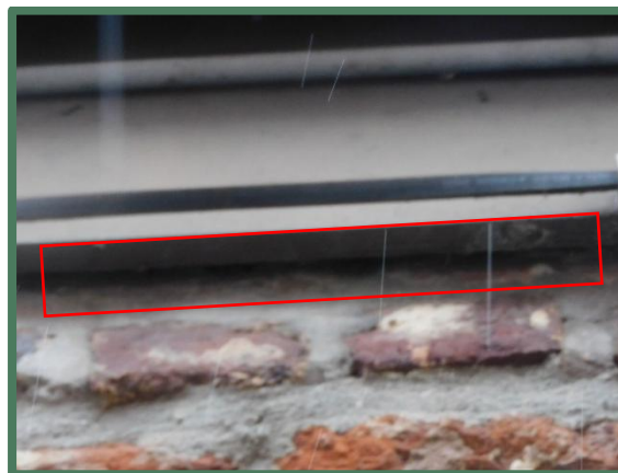
Foto 13: Kier achter houten plank onder dakgoot.
