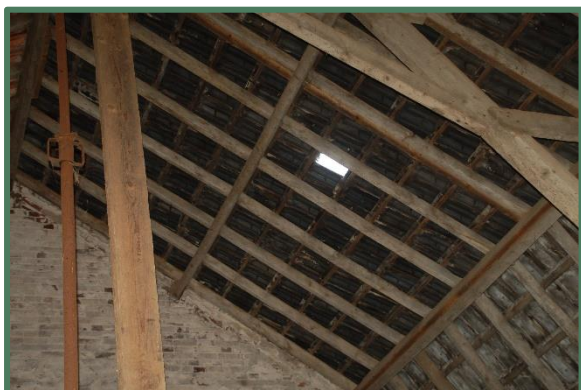
Niet onderschoten dak
